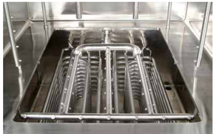
Eiskondensator-kammer mit CIP-/SIP-Verrohrung
