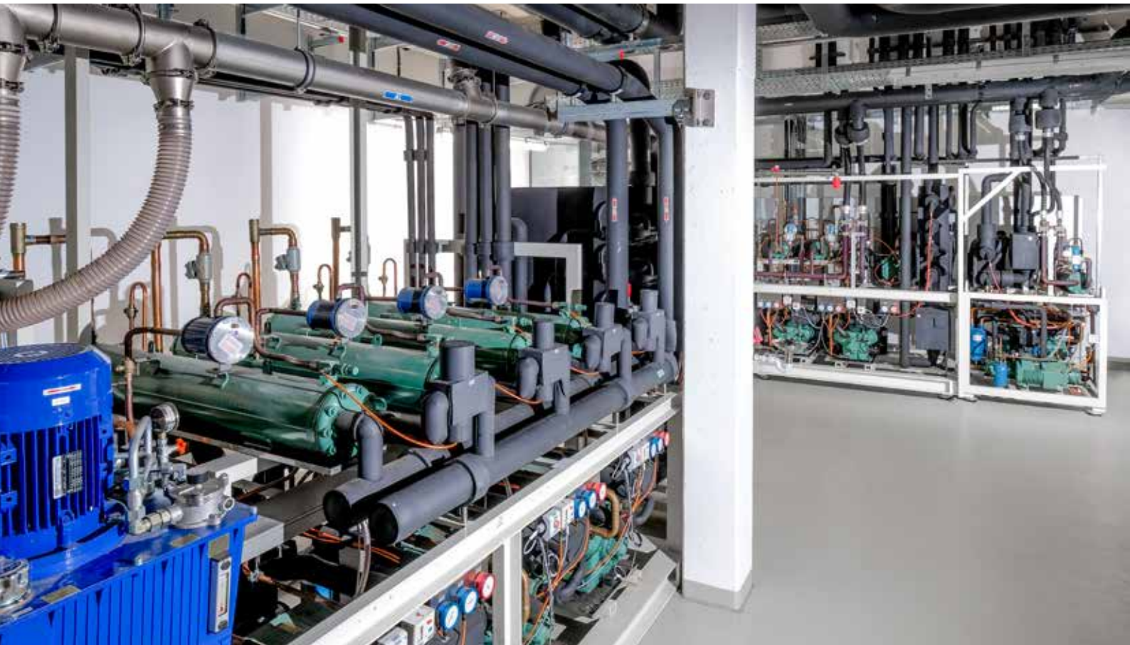
Technikbereich mit Kältesystemen für mehrere Gefrier-trockner
